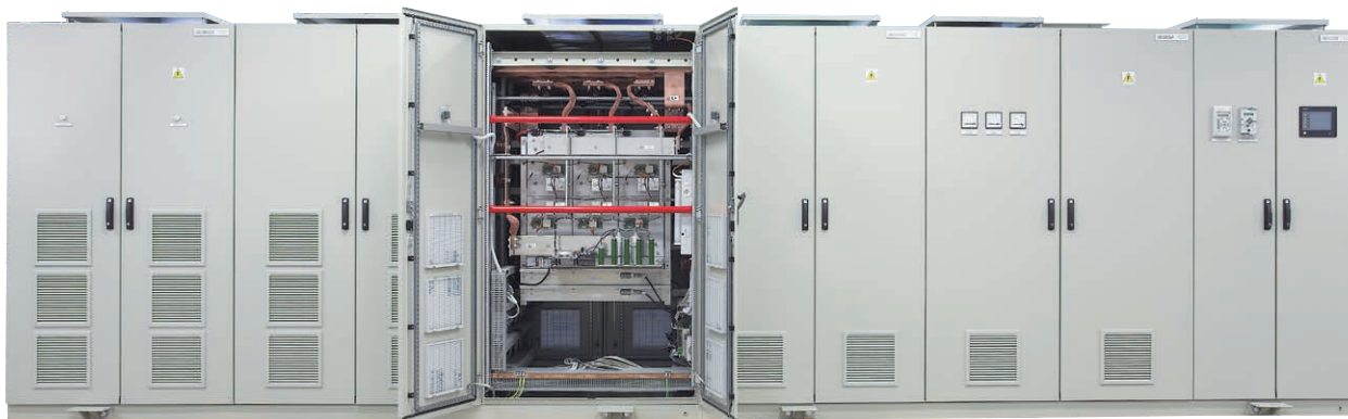
Szafy wzbudzenia generatora 600 MW
