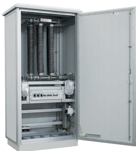
Szafa zewnętrzna kablowa dla stacji elektroenergetycznej
