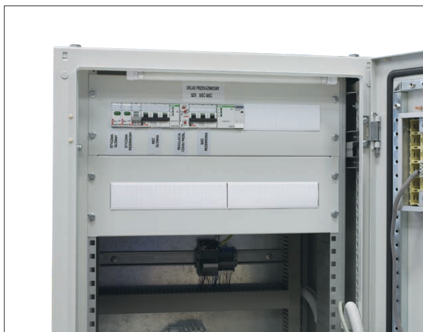
Układ przełącznikowy SZR zamontowany w szafie
