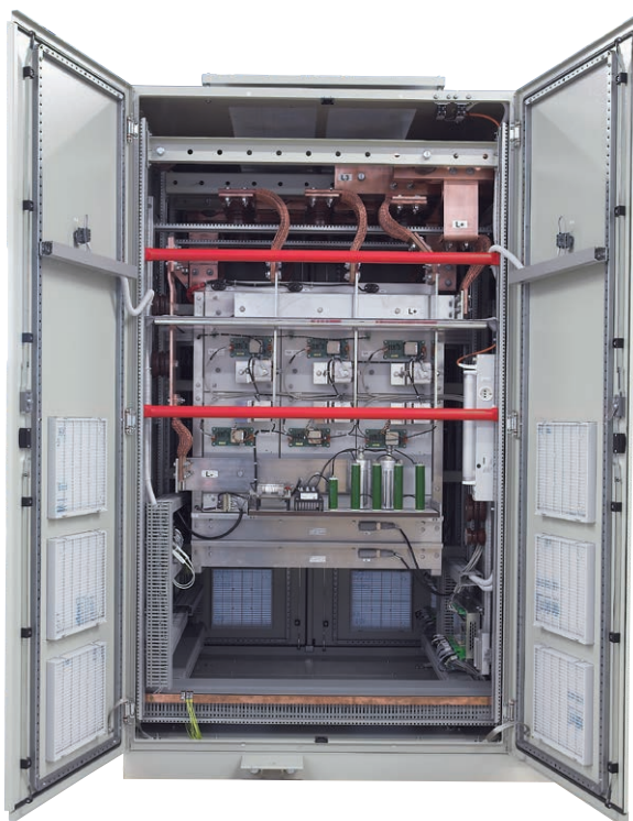
Szafy wzbudzenia generatora – pole prostownika
