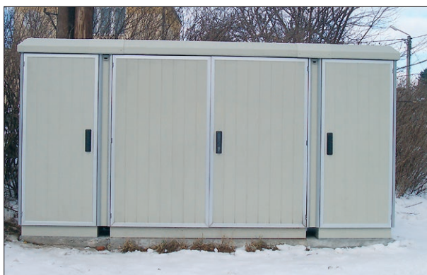
Szafa po rozbudowie
