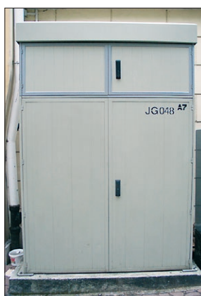
Szafa po rozbudowie
