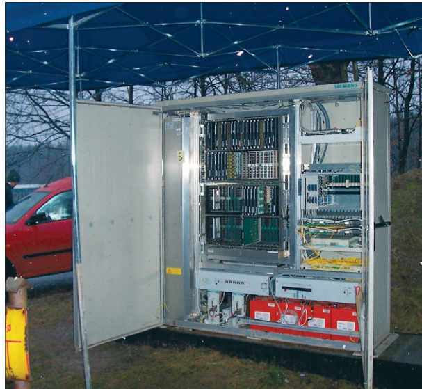
Szafa przed rozbudową
