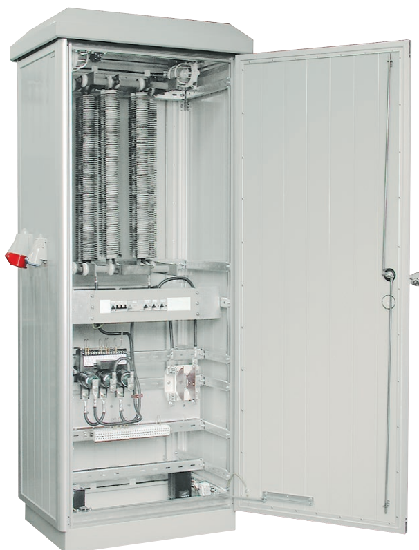
Szafa doziemienia dla stacji elektroenergetycznej
