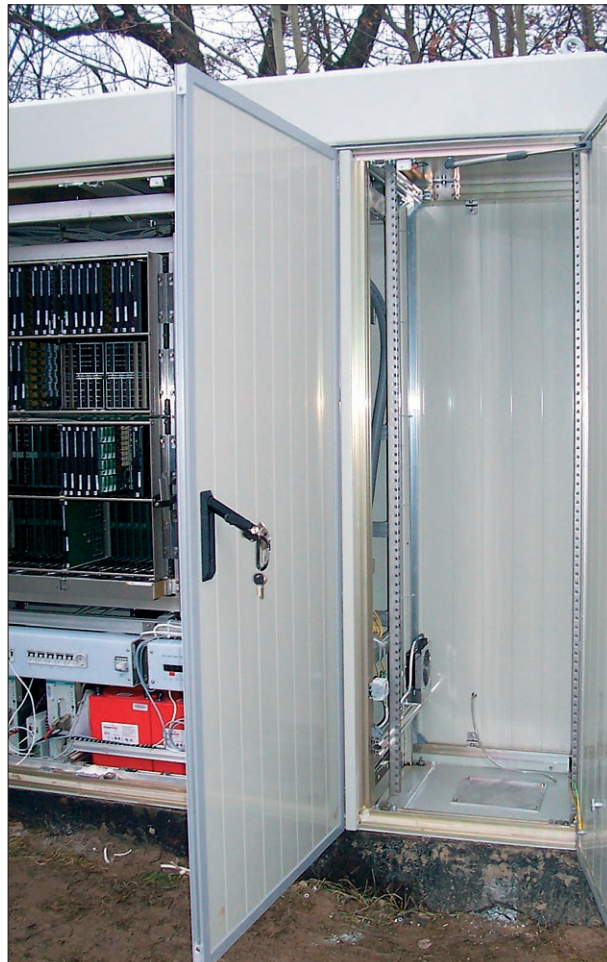
Szafa po rozbudowie
