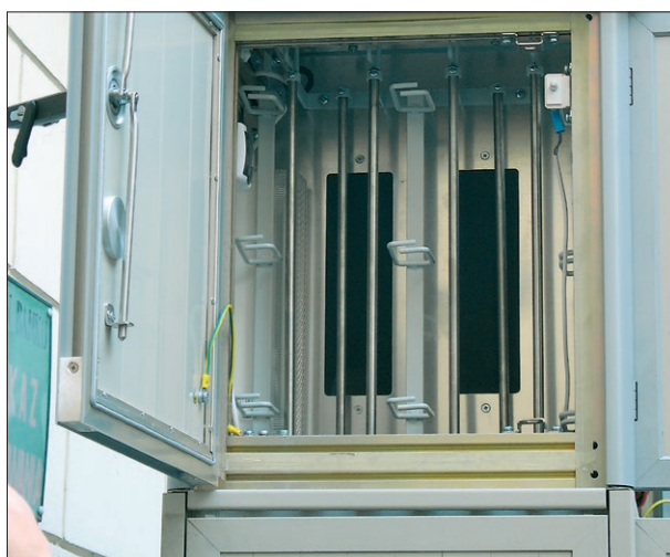
Szafa po rozbudowie
