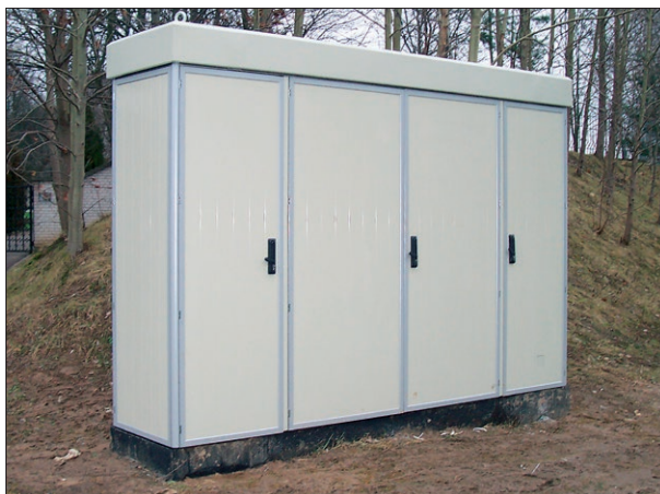
Szafa po rozbudowie
