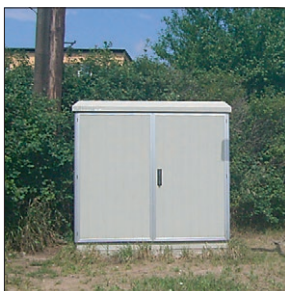
Szafa przed rozbudową
