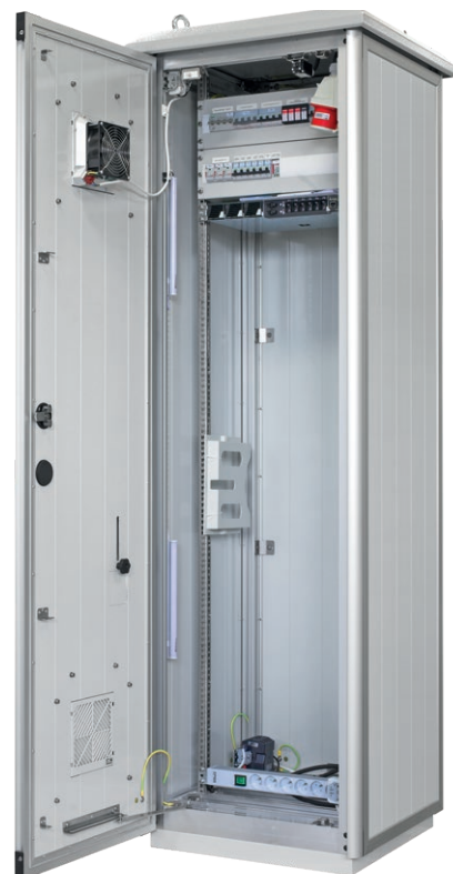
Szafy do systemów kolejowych
