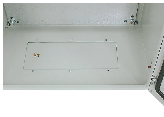
Заглушка, установленная в нижней части шкафа
