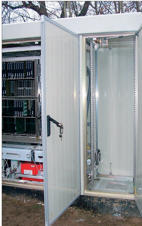
Шкаф после реконструкции
