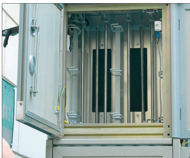
Шкаф после реконструкции
