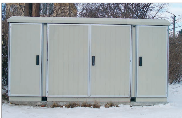
Шкаф после реконструкции
