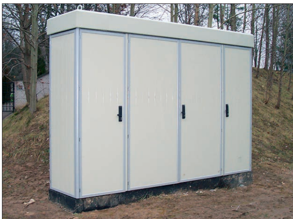
Шкаф после реконструкции
