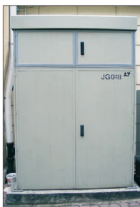
Шкаф после реконструкции
